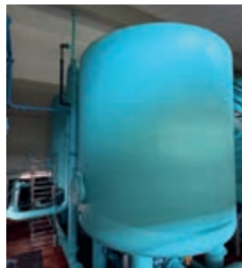
Aktivkohlefilter im Wasserwerk Erpfingen
